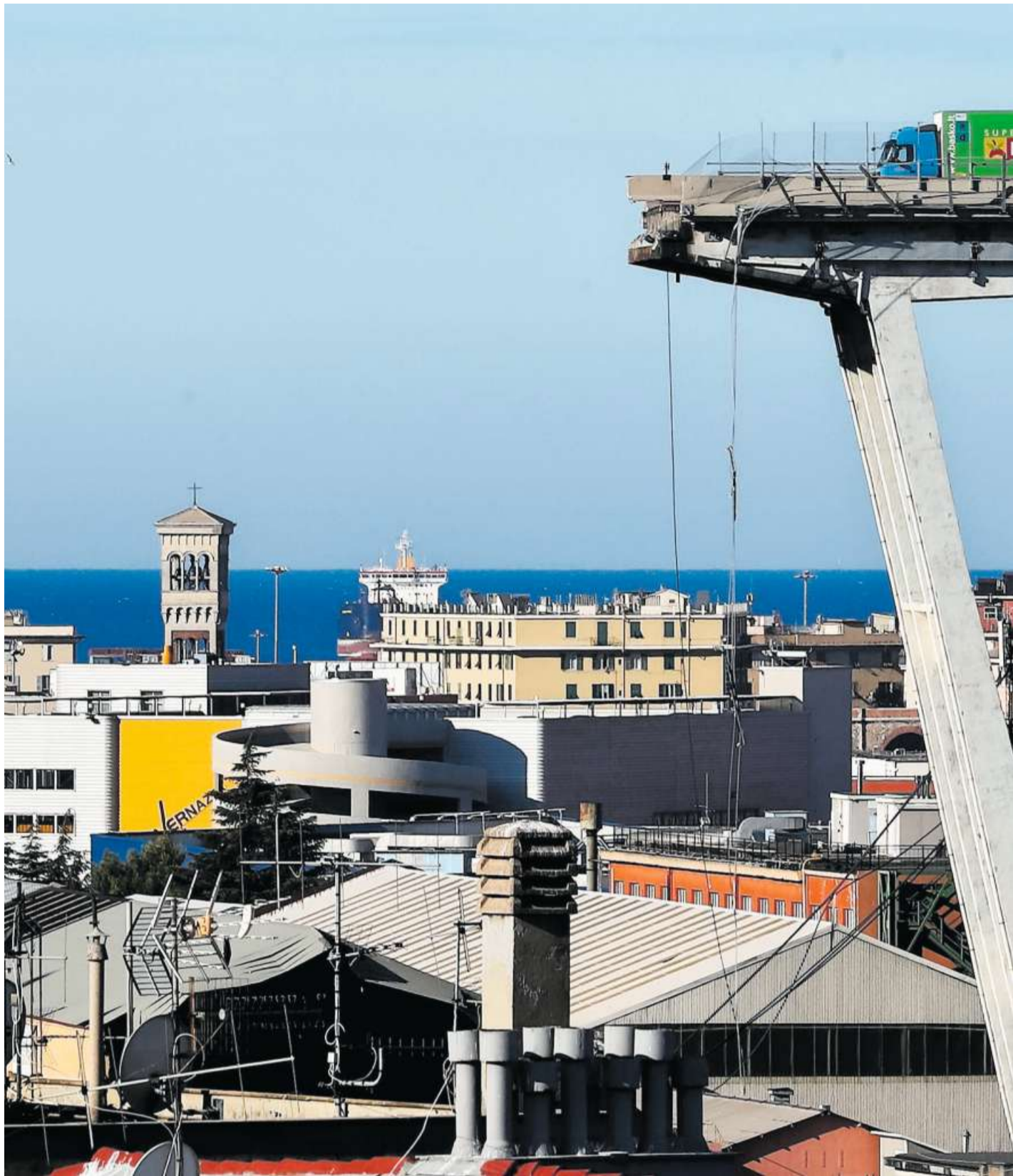
Ein gespenstisches Bild: Die Morandi-Brücke in Genua führt nach dem Abbruch eines 200 Meter langen Teilstücks ins Leere.
